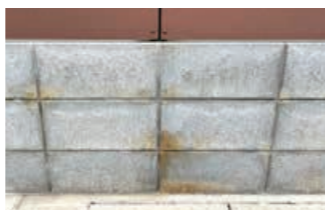
㉕ コンクリートブロック汚れ
